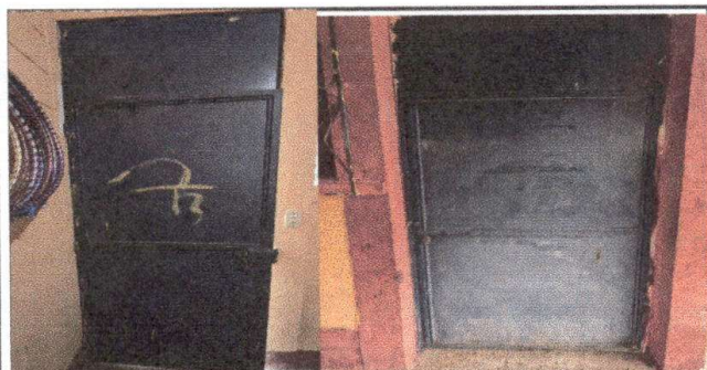
Foto 5: Puertas de aulas, deterioradas, sin chapas seguras.
