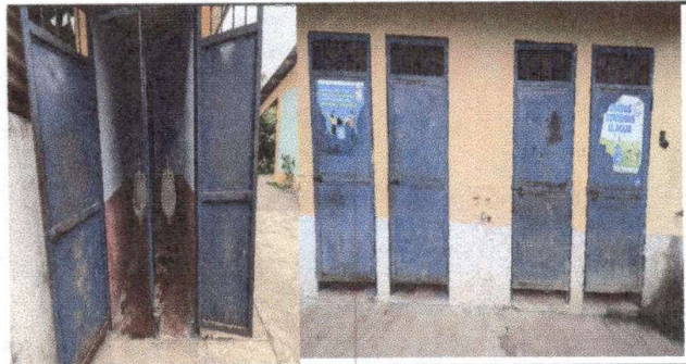
Foto 6: Puertas de santiarios en mal estado, sin pasadores.
