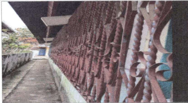
Foto 2: Balcones en las ventanas, con deterioro.
